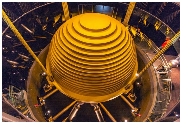
Figura 3.4: Aumento de amortiguamiento por medio de masa sintonizada, en Torre Taipei 101.
